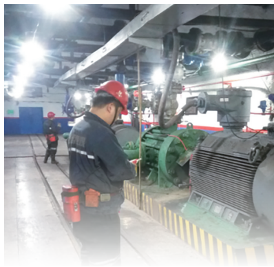
为守牢矿井安全生产防线,双柳煤矿对矿井主排水系统进行深入排查,以闭环式管控、精细化运维织密汛期安全防护网。张红霞 摄影报道
