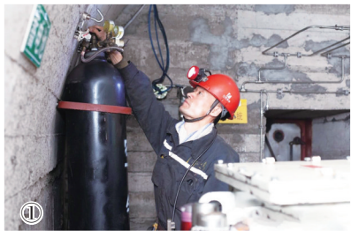
图①为水峪煤业通风区职工查看避难硐室设备设施。
