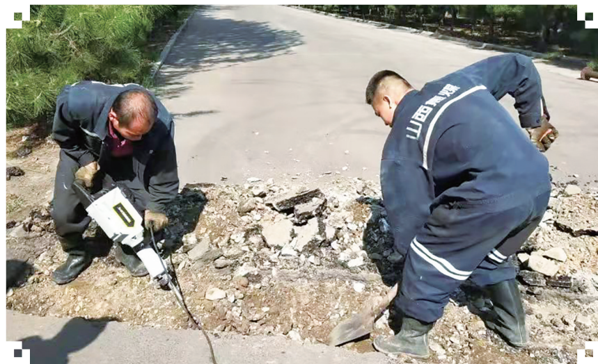
近日,宜兴煤业水暖队在日常管网巡查时,发现洗煤厂办公楼前堤坝下有渗水现象,立即上报并制定维修方案开展抢修工作,地面开挖、焊接管路、紧固螺栓,各部门各司其职,紧密配合,克服高温酷热、操作空间狭小等困难,经过13个小时连续作业,在最短时间内顺利完成抢修任务。 任志明摄影报道
