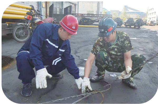
近日,从宜兴煤业公司机运区组织钢丝绳插编专项实操培训,不仅使参训人员全面掌握了插编钢丝绳作业步骤及注意事项,更有利于提高日常工作效率和作业安全。 王晓俊摄影报道
