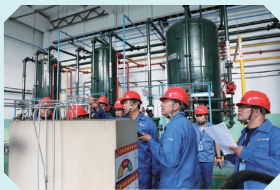
为做好国庆、中秋两节期间的安全生产工作,发电厂扎实开展了安全隐患大排查,全面消除人、设备、现场安全隐患,有效防范各类安全生产事故,为节日期间的安全发电营造安全环境。薛丽萍 摄影报道
