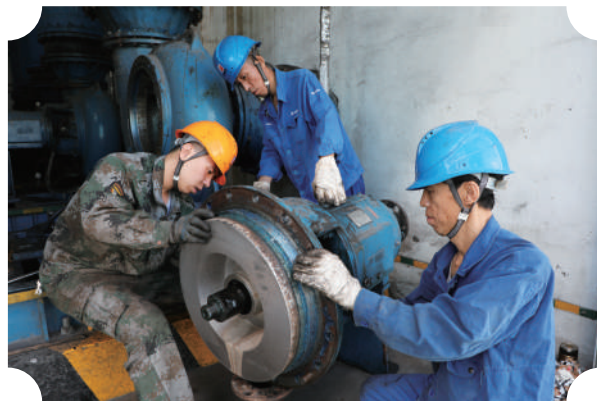
发电厂注重设备的维护保养,坚持该修必修的原则,加大设备定期检修力度。9月2日,发电厂拉开了机炉C修序幕,及时消除设备安全隐患,确保设备安全投入率完好率。该厂利用启河线检修的机会,对1#机炉进行为期4天的公共部分消缺;对2#机炉进行为期30天的C修。安监人员加大对机炉检修和改造现场的安全监管力度,加强检修技术监督,严格管控安全、质量和进度,确保安全标准作业,高质量机组检修和改造任务。
