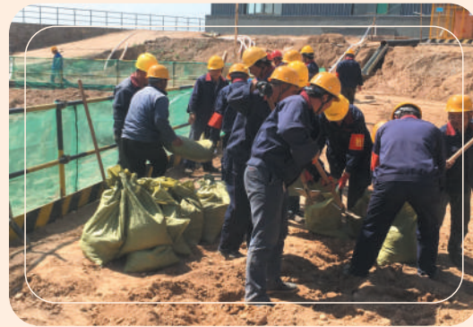
建安公司在正升项目工地组织开展了防汛应急演练。王硕 摄影报道
